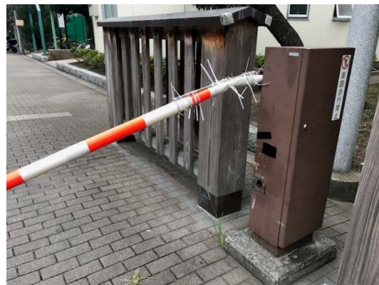
破損した状態のゲート
